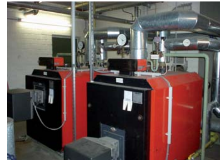
Abbildung 2: Heizungszentrale Betriebsgebäude, Siegburg
