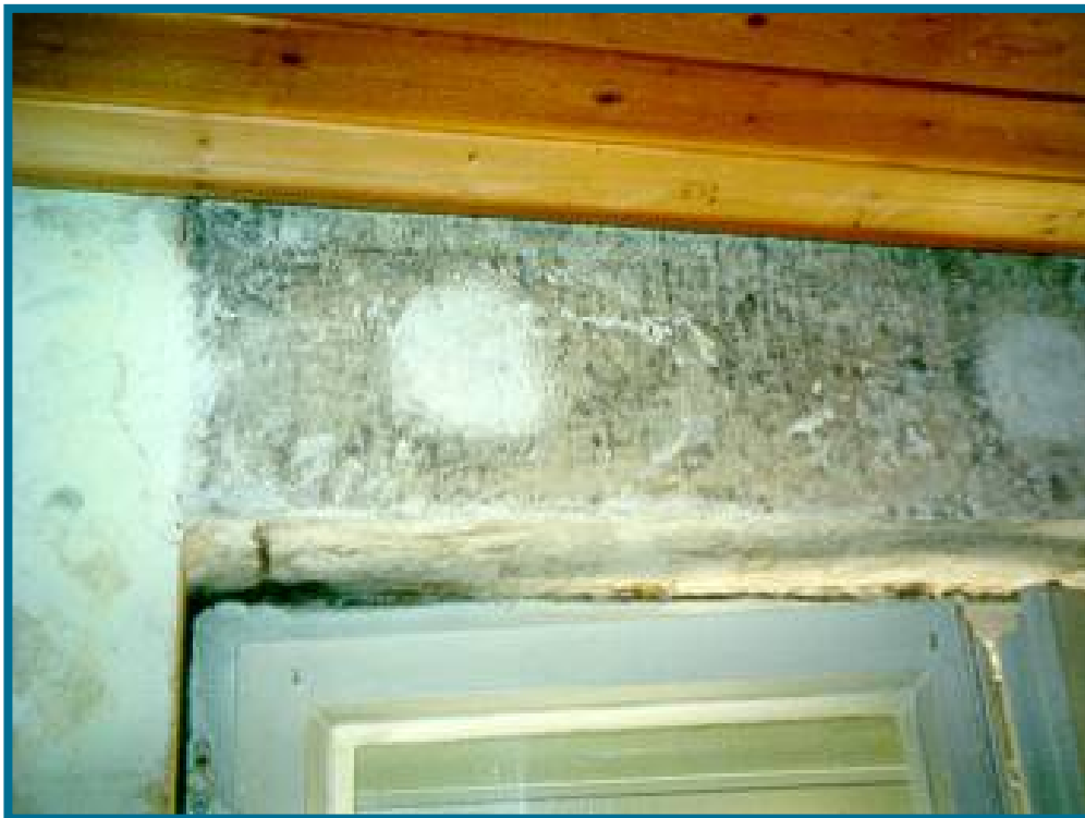
Schimmelpilze hinter der Dämmung
