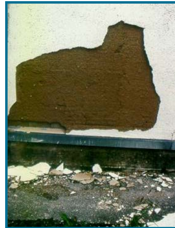
Frostschaden am Außenputz
